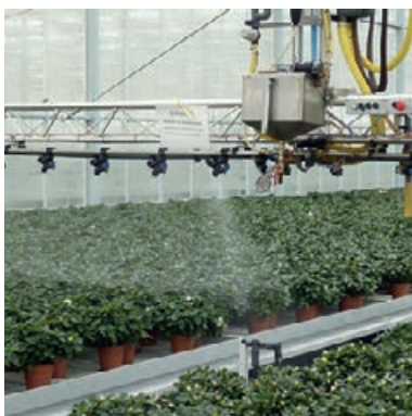
Abbildung 8: Horizontalgestänge im Gewächshaus
